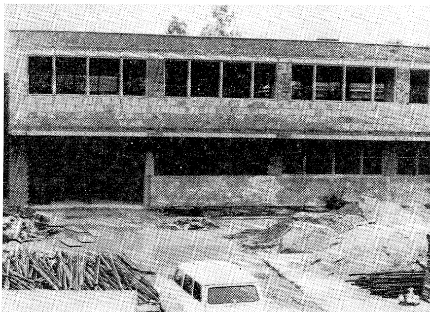
Nová výrobní hala umožní Eramu zvýšit výrobu elektrických rozváděčů.
